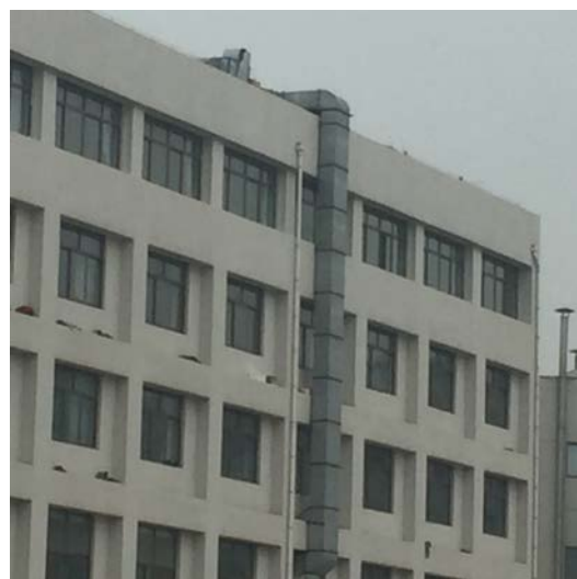
图 3-2 食堂油烟排气筒
